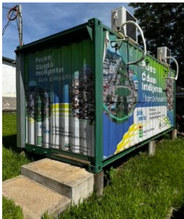
Figura 33 — Imagens externa e interna do contêiner do Data Center
