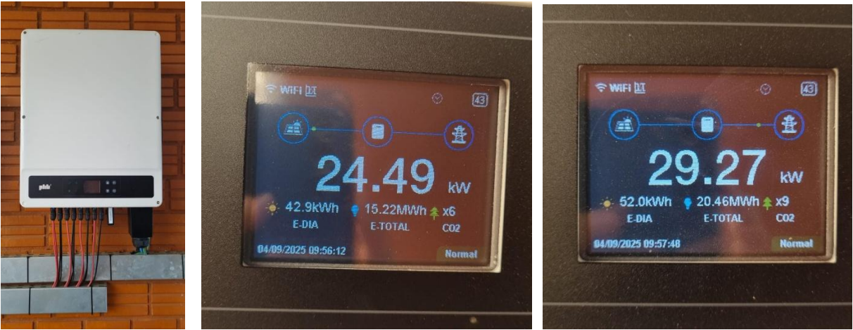
Figura 23 — Medições dos inversores 1 e 2 da Usina Fotovoltaica do CEI (em 4/9/2025, às 9h56 e 9h57)
